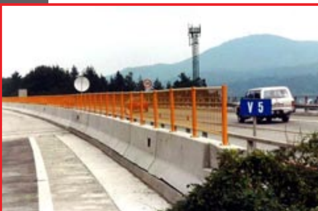
Übersteigenschutz mit Stahlsprossen
