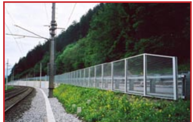
Übersteigenschutz mit Gitter
